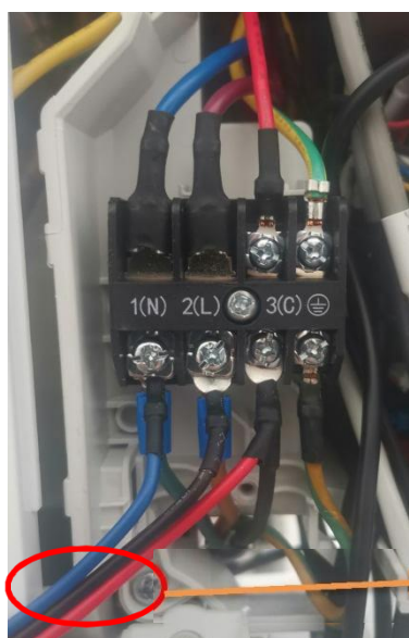
IDU kabeláž svorkovnice
