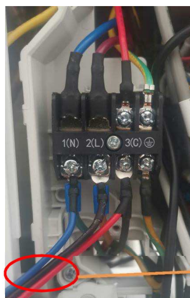
IDU kabeláž svorkovnice
